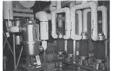
鬼怒川温泉一柳閣新館 SD-30型4基・SD75型1基
